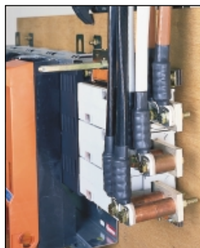
Fig. 2 Cable con. above
