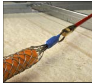
Cable Scout+ og trekkefjær.
