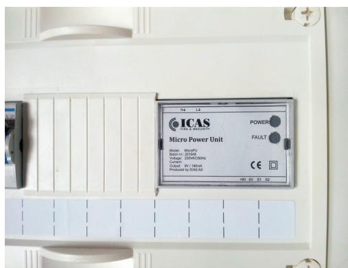
ICAS Micro Power Unit: IMC-Pu, i sikringsskapet
