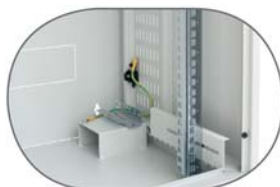
KABLING - SEKSJON 12U
