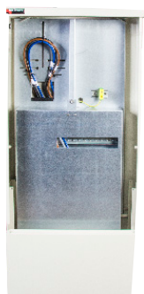
TKSS forberedt til 400V montering og med IP 20 deksel
