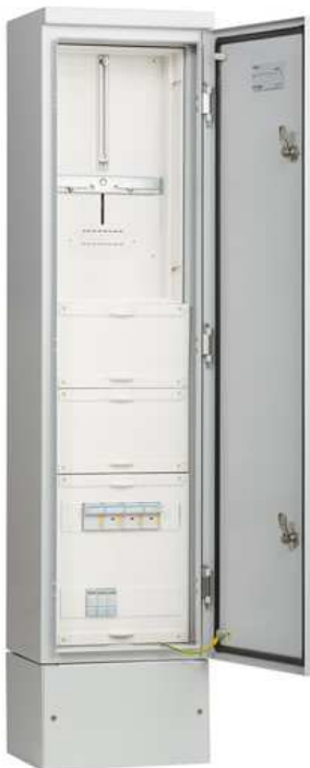
Målerskap 400V TN 125A, for målertrafoer
